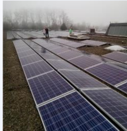
179 kWp Busdepot Goslar 25. März 2019
