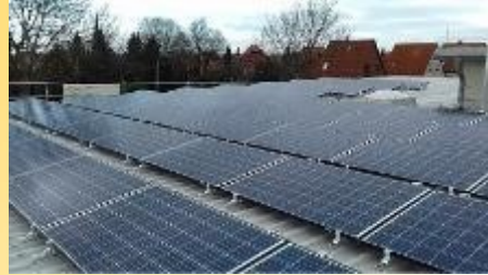
60 kWp Feuerwache Othfresen
